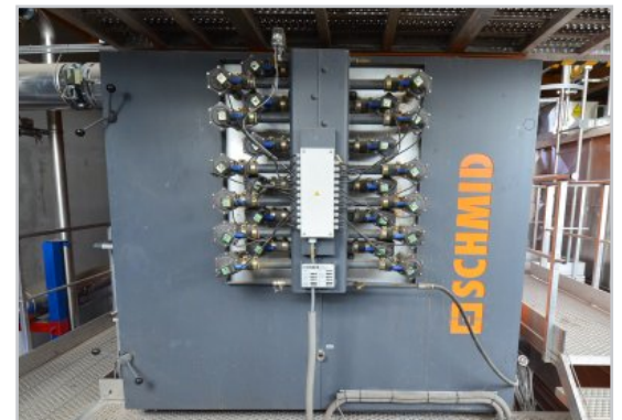
L'échangeur de la chaudière Schmid de Riom avec ses ramoneurs pneumatiques, photo FD
